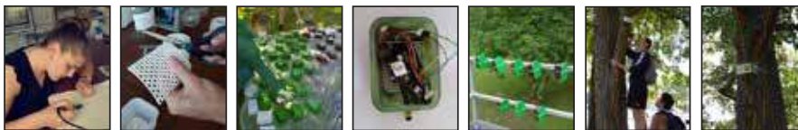
Zusammenbau, Kalibrierung und Installation der Sensoren
